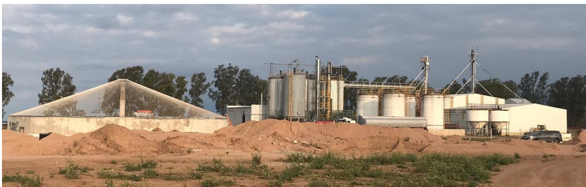
1. Vista de Mini destilería de etanol con planta de biogás (en construcción) para autogeneración de energía térmica para la planta. Rayo Cortado (Córdoba).
