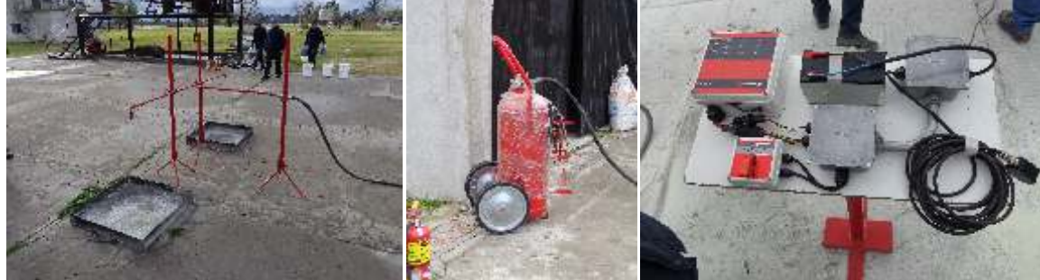
Figura 5: Izquierda: imagen de las toberas preparadas para realizar la descarga en las bandejas de evaluación. Centro: imagen del cilindro con el agente extintor ABC 90 utilizado en los ensayo. Derecha: Panel de control del sistema con actuador manual de la válvula de descarga.
