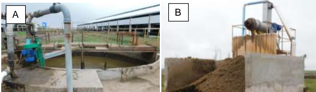
Imagen 6. Deposito de efluentes (A) y tornillo de separación de residuos (B)
