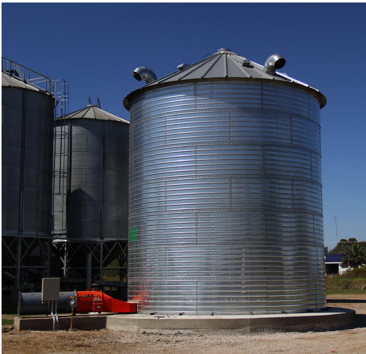
Figura 1. Silo-Secador INTA instalado y en funcionamiento.
