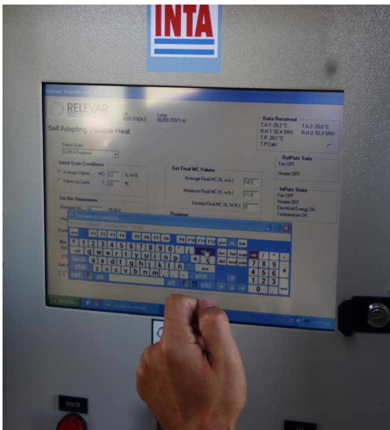
Figura 4. Vista del panel de control del controlador automático del sistema.
