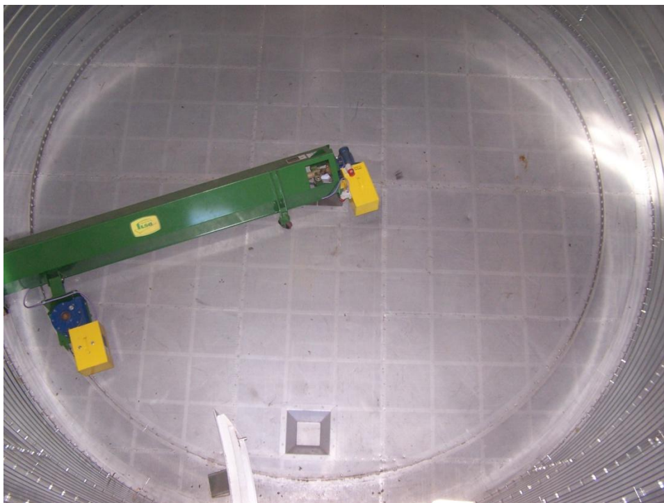
Figura 3. Vista del piso plano totalmente perforado. También puede verse la rosca barredora encargada de la limpieza final del silo (opcional).
